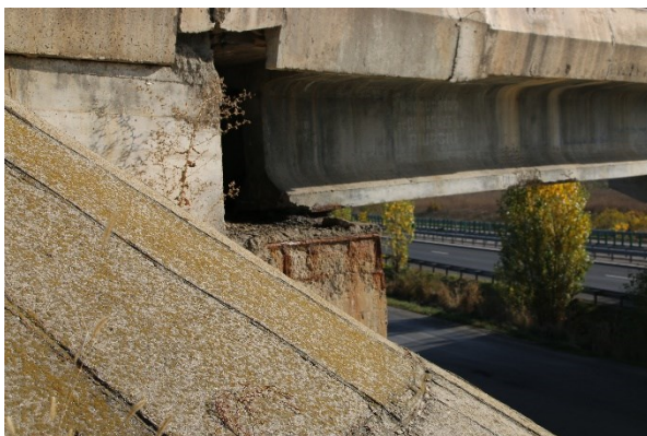
Fotografia 17. Detaliu bancheta culee Lehliu, spre București: beton corodat, armături vizibile și puternic corodate. Plăcuțele aparatului de reazem al grinzii marginale corodate.
