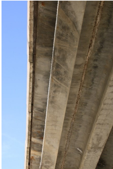
Fotografia 7. Vedere la partea inferioara a grinzii marginale de pe deschiderea marginala Lehliu: crăpătură longitudinală pe fața inferioară a grinzii, infiltrații prelinse pe fața laterală a grinzii, fisuri și pete de rugina în placa grinzii, armături cu strat de acoperire insuficient pe tăpile grinzilor prefabricate.
