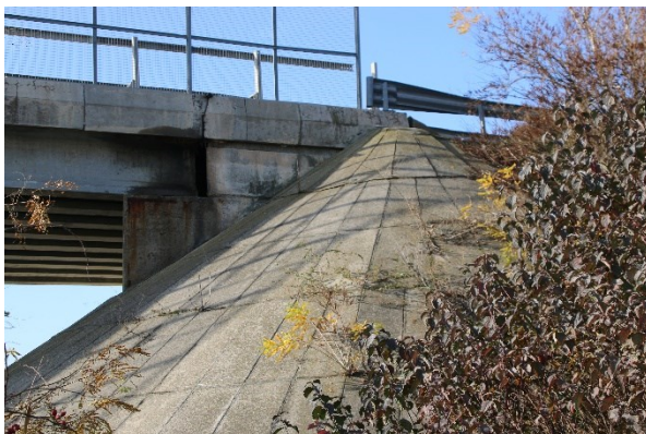
Fotografia 15. Vedere culee Lehliu dinspre Constanta: infiltrații puternice prin rost, beton și armături puternic corodate in bancheta, eflorescente pe bancheta și zidul întors.
