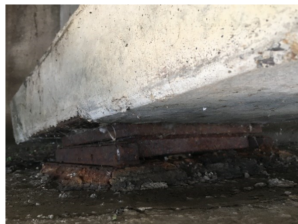
Fotografia 42. Detaliu aparat de reazem pe culeea Lehliu: plăcuțele metalice și opritorii aparatului de reazem cu coroziune puternică, prezenta apei pe bancheta.
