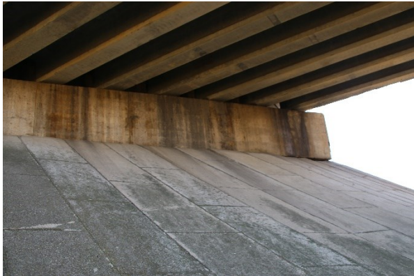
Fotografia 19. Vedere bancheta culee Razvani: infiltrații puternice prin rostul de pe culee prelinse pe fața banchetei, tasarea umpluturii și deplasarea pereului din fața culeei la capătul banchetei.
