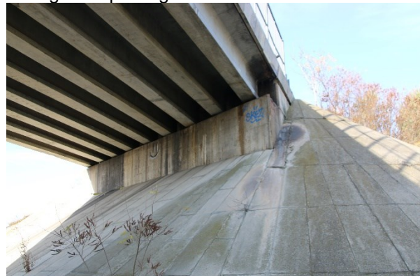
Fotografia 12. Vedere la partea inferioara a suprastructurii spre culeea Lehliu: infiltrații puternice prin rostul de pe culee prelinse pe bancheta, armături cu strat de acoperire insuficient pe fețele inferioare ale grinzilor.
