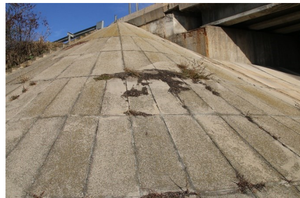
Fotografia 16. Detaliu racordare culee Lehliu cu terasamentul, spre București: vegetație in rosturile dintre plăcile pereului, beton și armături puternic corodate in bancheta.
