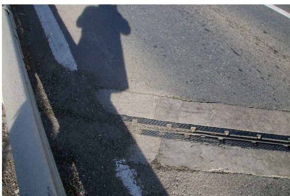
Fotografia 29. Vedere la nivelul părții carosabile in dreptul rostului de pe culeea Lehliu: grinzile de fixare a dispozitivului de rost cu fisuri, neetanseizarea rosturilor dintre grinzile de fixare si asfalt, dispozitiv de rost înglobat in praf.
