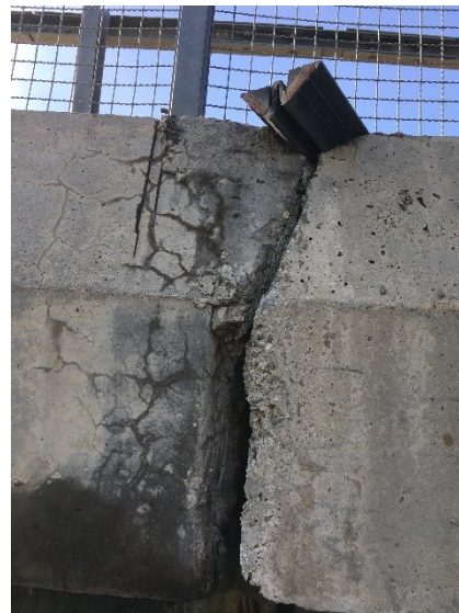
Fotografia 46. Detaliu grinda de parapet în dreptul rostului: dop de beton turnat în rost, faianțarea elementelor prefabricate ale grinzii de parapet.
