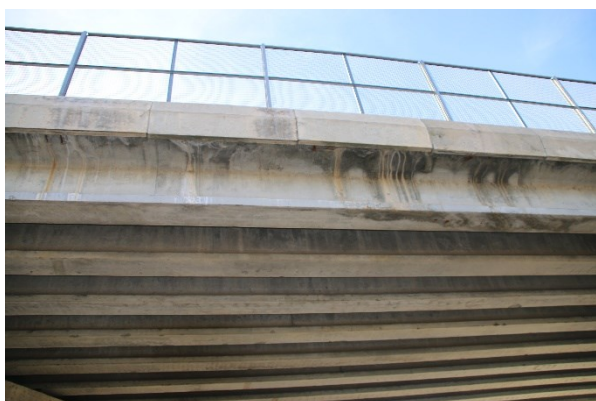
Fotografia 3. Infiltrații prin rostul dintre elementele prefabricate ale grinzii de parapet prelinse pe fetele grinzii marginale, degradarea betonului din grinzile marginale (fisuri in placa si pe talpa grinzii, pete de rugina).
