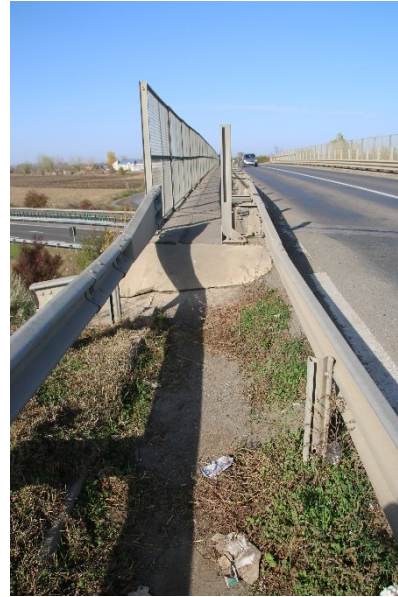
Fotografia 32. Vedere pod la nivelul părții carosabile în zona de racordare trotuar-acostament: acces dificil de pe acostament pe trotuarul podului, prezenta vegetației pe acostament.
