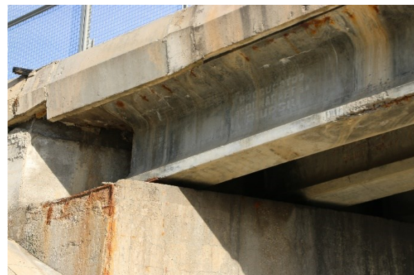
Fotografia 18. Detaliu bancheta culee Lehliu capăt București: infiltrații puternice prin rostul de pe culee, beton degradat in bancheta culeei, armatura descoperita și corodată. Beton degradat in placa și bulbul grinzii marginale: armatura vizibila și corodată, fisuri și crăpături.
