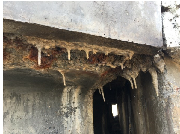
Fotografia 40. Detaliu în zona rostului pe culeea Lehliu: infiltrații puternice, stalactite, beton corodat în placa grinzii, pete de rugina, rost blocat cu beton.
