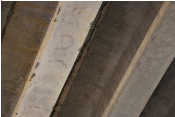
Fotografia 9. Detaliu la partea inferioara a tablierului: infiltrații prin rosturile longitudinale dintre grinzi, fisuri și pete de rugina în plăcile grinzilor prefabricate.
