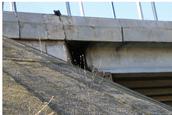
Fotografia 26. Detaliu grinda de parapet in zona rostului de dilatație de pe culee: rostul este blocat cu beton monolit, deplasarea nefiind permisa.
