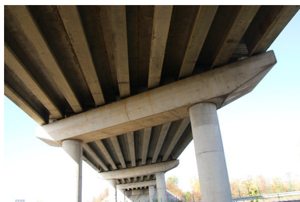
Fotografia 6. Vedere la partea inferioara a suprastructurii spre culeea Lehliu: armaturi cu strat de acoperire insuficient la tăpile grinzilor prefabricate, infiltrații pe rigla pilei Razvani, beton de fata văzută cu defecte de suprafață in pile si grinzi (imperfecțiuni geometrice, culoare neuniforma, pete de rugina).
