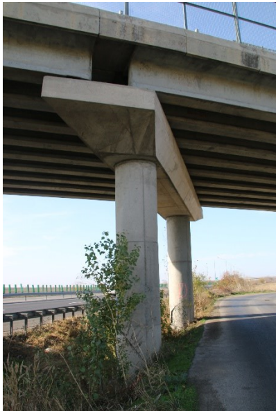
Fotografia 13. Vedere la pila Lehliu dinspre Constanta: beton de fata văzută cu defecte de suprafață in rigle și stâlpi (imperfecțiuni geometrice, culoare neuniforma, pete de rugina).
