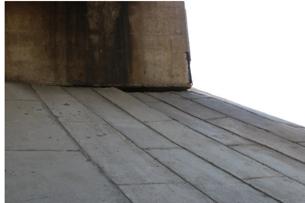
Fotografia 20. Detaliu Bancheta culee Razvani: tasarea umpluturii și deplasarea pereului din fața culeei la capătul banchetei, beton exfoliat, armături foarte corodate în bancheta.
