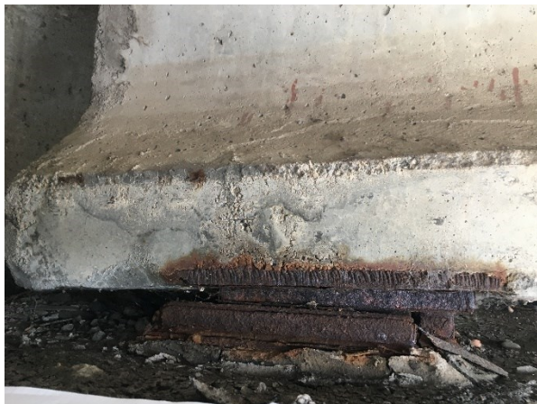
Fotografia 43. Detaliu aparat de reazem pe culeea Lehliu: plăcuțele metalice și opritorii aparatului de reazem cu coroziune puternică, distrugerea blocului de rezemare de sub reazem.
