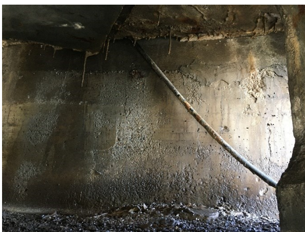
Fotografia 27. Detaliu zid de garda si bancheta culee Lehliu: infiltrații prin rost, stalactite, defecte de suprafață ale betonului din zidul de garda (imperfecțiuni geometrice, culoare neuniforma, pete de rugina, agregate la suprafață).
