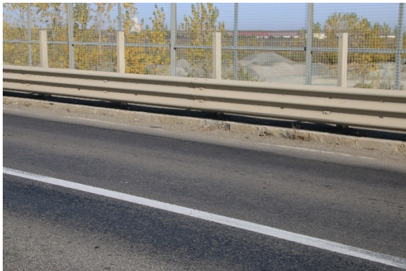
Fotografia 33. Detaliu pe cale: borduri degradate cu beton exfoliat, prezenta vegetației lângă borduri, lipsa lisei superioare a parapetului de siguranță.
