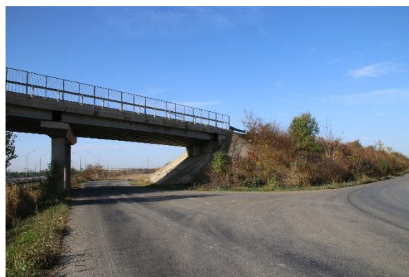
Fotografia 2. Vedere dinspre Constanta deschidere marginala Lehliu: infiltrații prin rostul de pe culee prelinse pe bancheta si prin rosturile dintre elementele prefabricate ale grinzii de parapet.
