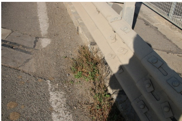
Fotografia 35. Detaliu pe cale în dreptul rostului de pe culeea Razvani: neetanseizarea rosturilor dintre grinzile de fixare și asfalt, dispozitiv de rost înglobat în praf, vegetație lângă bordura.
