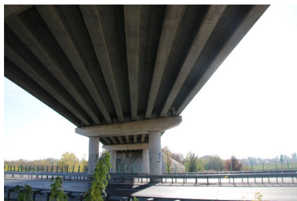
Fotografia 4. Vedere la partea inferioara a tablierului spre pila centrala: armaturi cu strat de acoperire insuficient la partea inferioara a grinzilor prefabricate, infiltrații pe fata laterala a riglei pilei.
