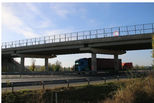
Fotografia 1. Vedere pasaj dinspre Constanta: defecte de suprafață ale betonului
