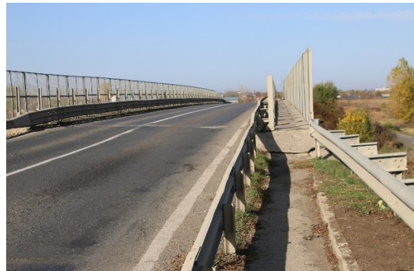
Fotografia 34. Vedere pe cale și trotuar în zona culeei: tasarea umpluturilor în spatele culeei, denivelarea cailor, asfalt cu ciupituri, fâgașe și zone poroase, degradarea betonului de pantă care face racordarea dintre trotuar și acostament, vegetație pe acostamentul rampei.
