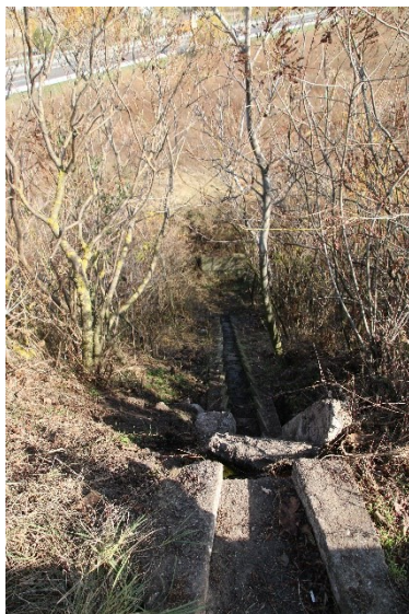
Fotografia 47. Casiu cu beton degradat.
