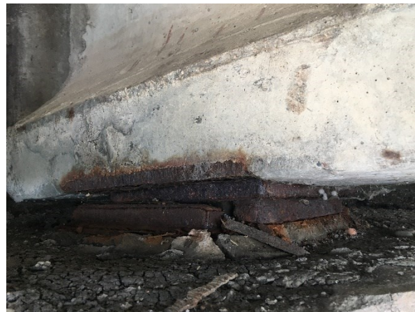
Fotografia 44. Detaliu aparat de reazem pe culeea Lehliu: plăcuțele metalice și opritorii aparatului de reazem cu coroziune puternică, distrugerea blocului de rezemare de sub reazem.
