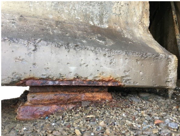
Fotografia 39. Detaliu aparat de reazem grinda marginala spre Constanta, culee Lehliu: plăcuțele și opritorii aparatului de reazem cu coroziune puternică.
