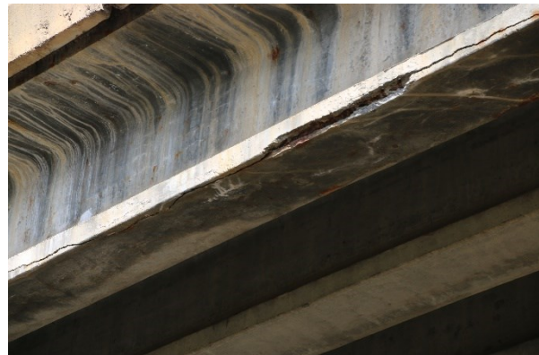
Fotografia 10. Detaliu la partea inferioara a grinzii marginale Razvani, spre București: infiltrații puternice prin rostul dintre grinda de parapet și grinda marginală, crăpături longitudinale și rețea de fisuri pe fața inferioară a grinzii, fisuri și pete de rugina în placa grinzii.
