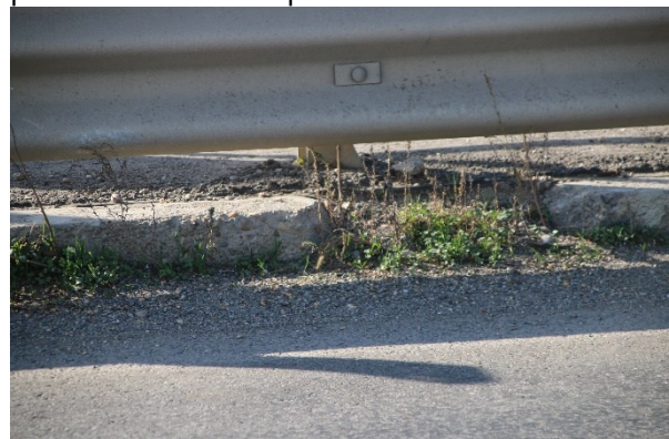
Fotografia 36. Detaliu pe cale: bordura distrusă încadrată de borduri degradate, depozite de praf și vegetație lângă bordura.
