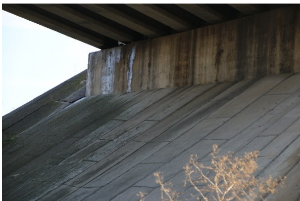
Fotografia 21. Detaliu bancheta culee Razvani: infiltrații prin rostul de pe culee prelinse pe fața banchetei. Beton cu defecte de suprafață în bancheta: imperfecțiuni geometrice, culoare neuniformă, pete negre, agregate la suprafață.
