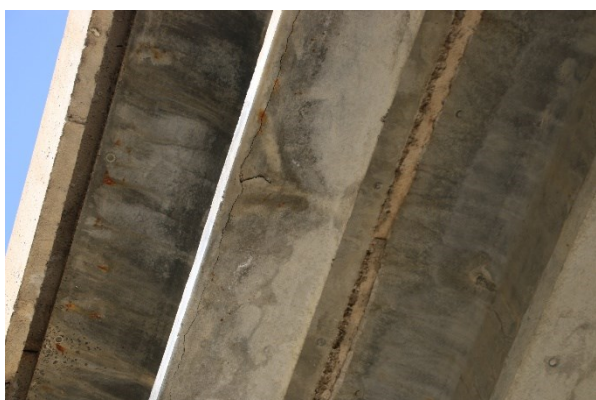
Fotografia 5. Detaliu la partea inferioara a grinzii marginale spre București, deschiderea marginala Lehliu: crăpătură longitudinala, beton exfoliat si armatura corodată in bulbul grinzii; infiltrații puternice prin rostul dintre grinda de parapet si grinda marginala prelinse pe placa grinzii, fisuri in placa si pete de rugina la placa grinzii marginale.
