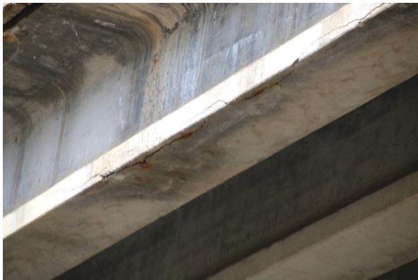
Fotografia 11. Detaliu grinda marginală, deschidere Razvani, spre Constanta: infiltrații puternice prin rostul dintre grinda de parapet și grinda marginală, crăpături longitudinale și rețea de fisuri pe fața inferioară a grinzii.
