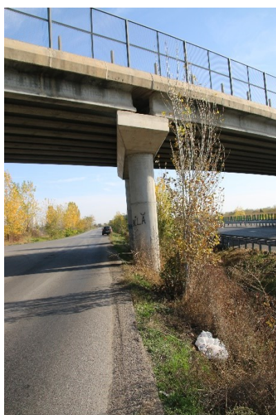
Fotografia 23. Vedere dinspre București pila Lehliu: infiltrații prin placa grinzii marginale prelinse pe inima și talpa, beton degradat în elementele prefabricate ale grinzii de parapet.
