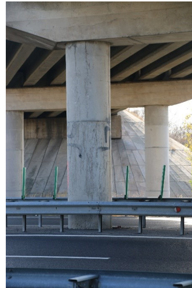
Fotografia 14. Vedere spre pila centrala: stâlpul pilei prezinta o rețea de fisuri și crăpături; infiltrații și fisuri in rigla pilei.
