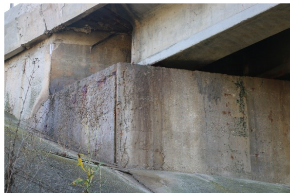
Fotografia 22. Detaliu bancheta culee Razvani spre Constanta: infiltrații prin rostul de pe culee prelinse pe fața banchetei, beton corodat, fisuri și crăpături verticale, armături corodate în bancheta. Pereu degradat (umplutura tasată, pereu crăpat, vegetație în rosturile pereului).
