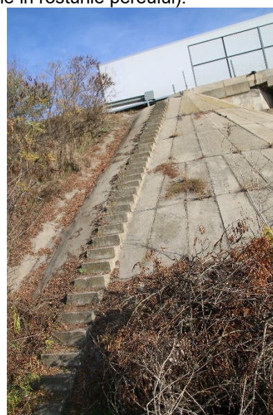
Fotografia 24. Vedere sfert de con culeea Lehliu spre București: crăpături în pereu, vegetație la baza sfertului de con și în rosturile pereului, scara de acces fără parapet, casiu colmatat cu vegetație.
