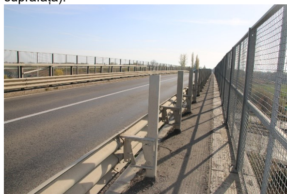
Fotografia 30. Vedere la nivelul părții carosabile: asfalt cu ciupituri si suprafață poroasa pe cale si pe trotuar. Lipsa lisei superioare la parapetul de siguranță, prezenta vegetației pe cale, lângă borduri.
