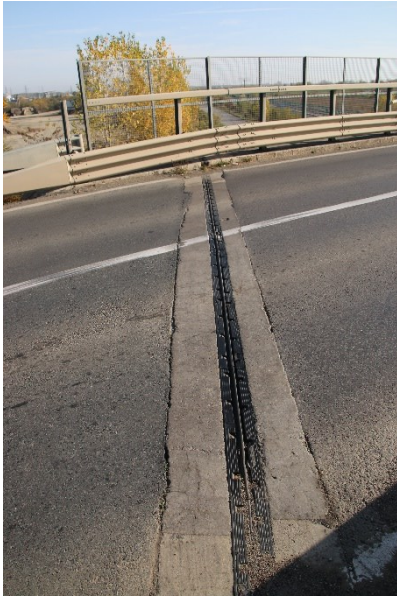
Fotografia 31. Vedere la nivelul părții carosabile în dreptul rostului de pe culeea Lehtiu: grinzile de fixare a dispozitivului de rost cu fisuri, neetanseizarea rosturilor dintre grinzile de fixare și asfalt, dispozitiv de rost înglobat în praf.
