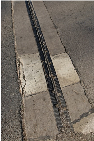
Fotografia 37. Detaliu rost culeea Razvani: rosturi neetanșate între grinzile de fixare și asfalt, dispozitiv de rost înglobat în praf, grinzi de fixare fisurate, dispozitiv de rost cu degradări.
