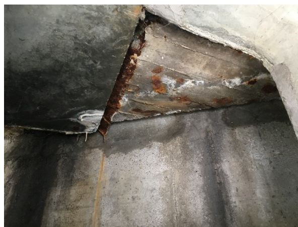
Fotografia 28. Detaliu zona de capăt tablier si zid de garda si bancheta culee Lehliu: infiltrații prin rost, stalactite, defecte de suprafață in zidul de garda (imperfecțiuni geometrice, culoare neuniforma, pete de rugina, agregate la suprafață).
