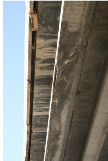
Fotografia 8. Vedere la partea inferioara a grinzii marginale Razvani, spre București: infiltrații puternice prin rostul dintre grinda de parapet și grinda marginală, crăpături longitudinale și rețea de fisuri pe fața inferioară a grinzii, fisuri și pete de rugina în placa grinzii.
