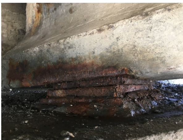
Fotografia 41. Detaliu aparat de reazem grinda marginala spre Constanta, culee Lehliu: plăcuțele metalice și opritorii aparatului de reazem cu coroziune puternică.
