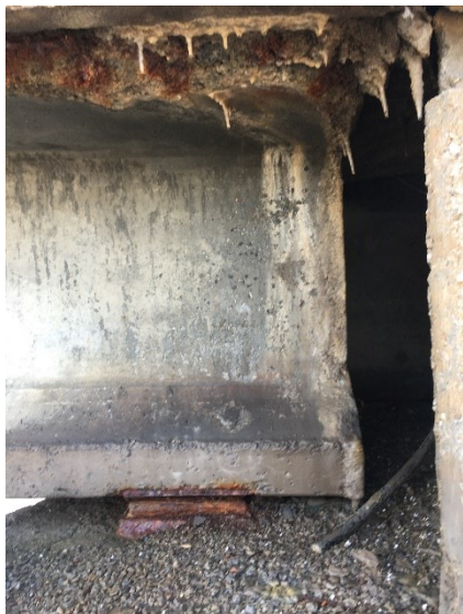
Fotografia 45. Detaliu rezemare grinda pe culeea Lehliu: infiltrații, stalactite, beton corodat în placa grinzii, pete de rugină, plăcuțele și opritorii aparatului de reazem cu coroziune puternică.
