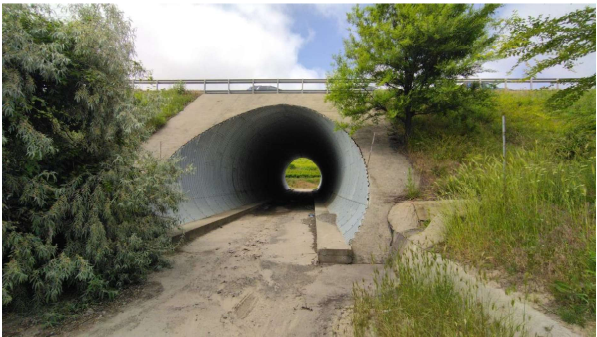
Foto 3. Absența unor deformări observabile ale structurii podețului din tablă ondulată.
