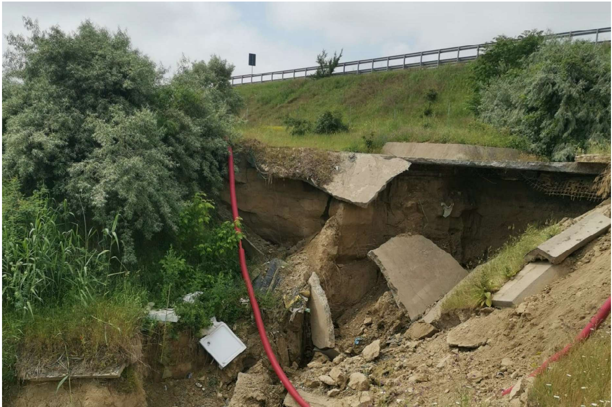
Foto 2. Prăbușirea platformei din beton la capătul aval al podețului
